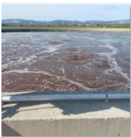
Grand bassin aération
