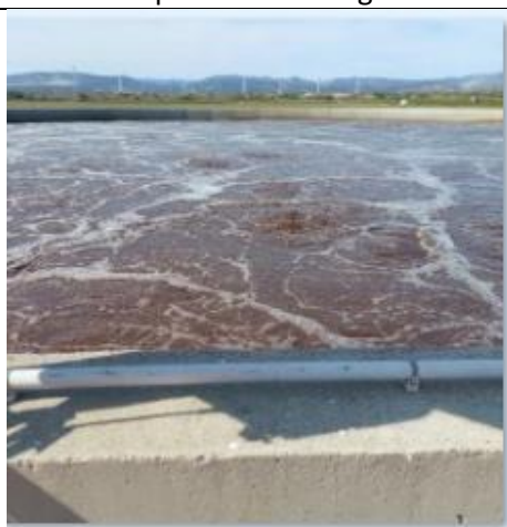
Grand bassin aération
